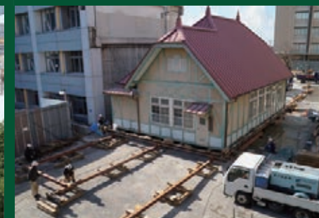
手動で曳家を行う様子 ※曳家=建築物をそのままの状態で行う建築工法
